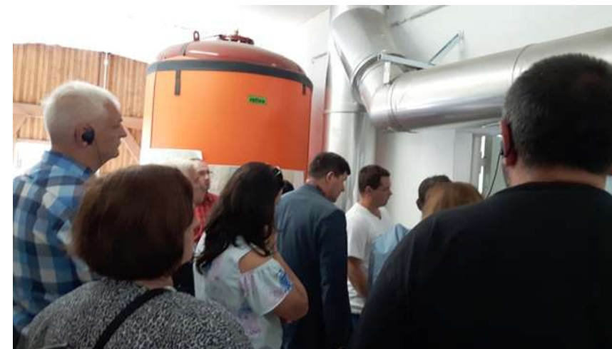
Lokalna ciepłownia gazowa
